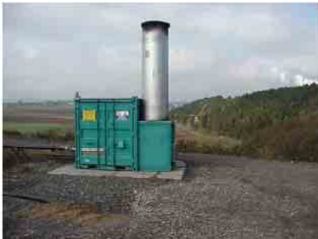
Abbildung 2.4: Deponiegasfackel auf der Deponie Warburg
