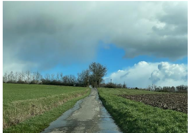
Mangelhafte Asphaltdecke (vgl. Maßnahme O58) Eversen - Entrup
